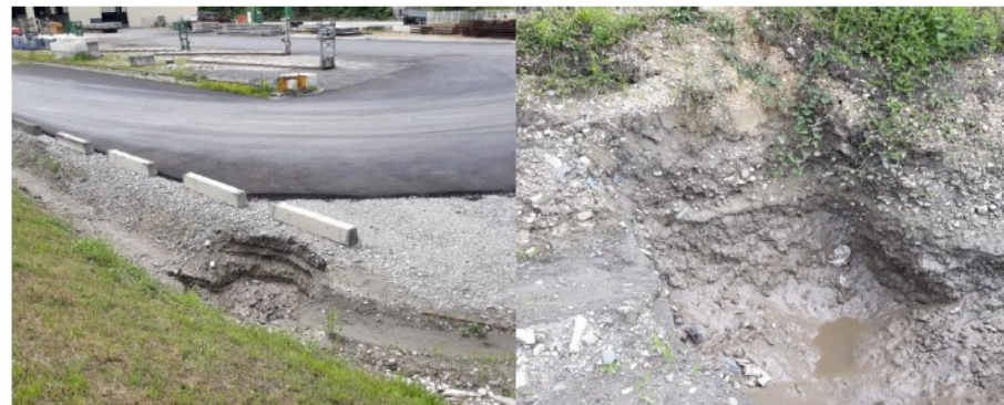
Figure 1 : Exemples de dommages sur digues, dus à l'homme, suite à travaux à proximité de l'ouvrage, sur pied de digue côté terre
