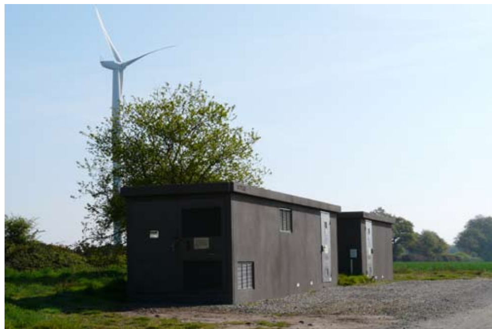
Le poste de livraison : une forme simple, une teinte sombre et un positionnement adossé au relief ou à la végétation
