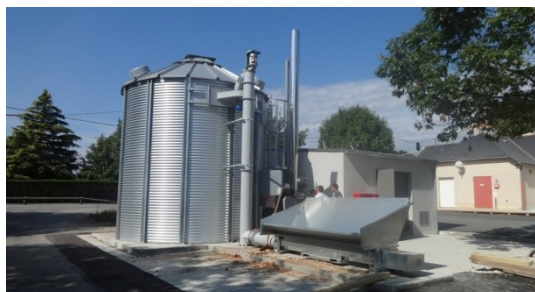
Illustration 4: chaufferie avec silo de plein pied de l'école Félix Leclerc (Bouvron)
