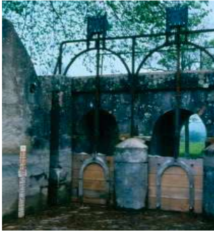
Vannes plates à glissières entretenues © DREAL Pays de la Loire
