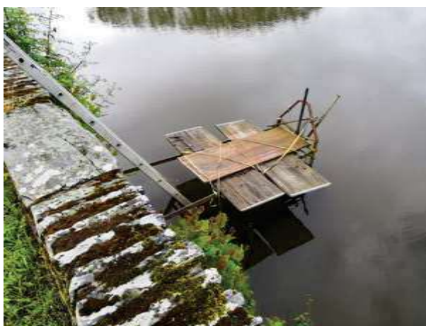
Accès dangereux à la tête de la vanne de fond, dispositif de manœuvre obsolète
