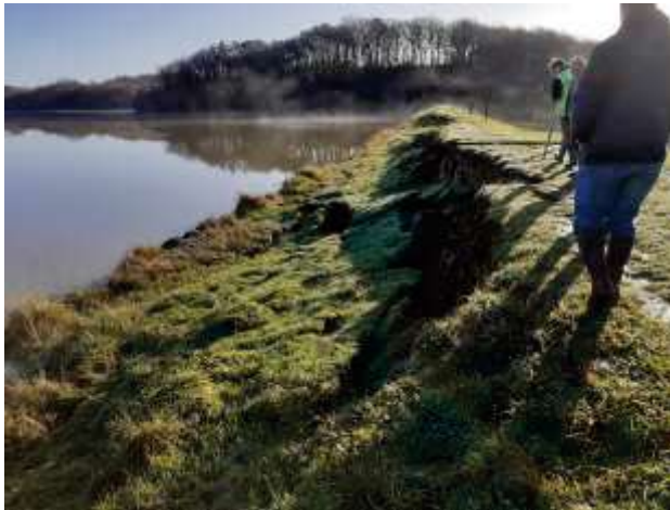
Glissement du parement amont d'un barrage sur la commune de Saint-Laurent-de-Gosse (Nouvelle-Aquitaine, novembre 2022) © SCSOH Nouvelle-Aquitaine
