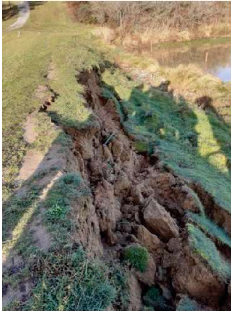
Glissement sur le parement amont d'un barrage © SCSOH Nouvelle-Aquitaine
