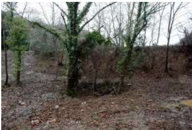
Arbres sur parement aval – Barrage de Capservy (11) © INRAE – Anthony Mouyeaux
