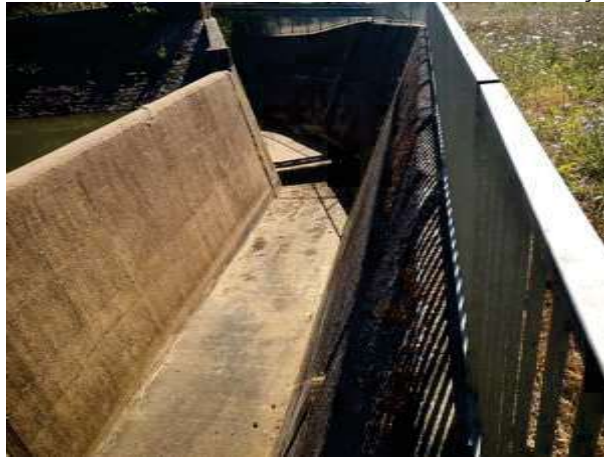
Déversoir entretenu © DREAL Pays de la Loire
