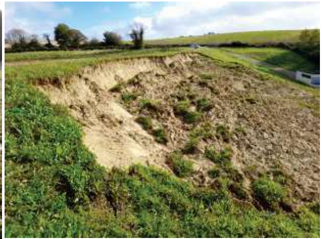
Glissement du parement aval d'un barrage sur la commune de Doazit (Nouvelle Aquitaine, octobre 2023) © SCSOH Nouvelle-Aquitaine
