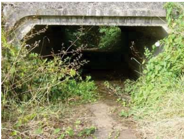
Évacuateur de crues à entretenir © DREAL Pays de la Loire
