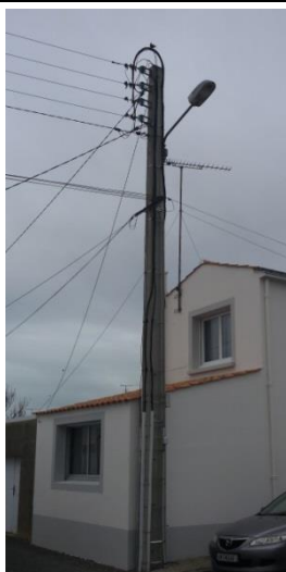
Réseau aérien BT sur support commun
