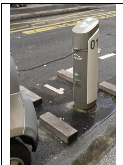
Borne de recharge électrique
