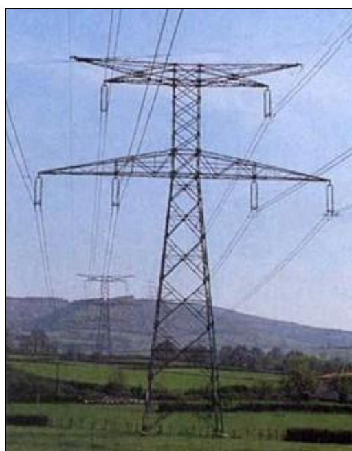
Réseau aérien HTB de 400 kV
