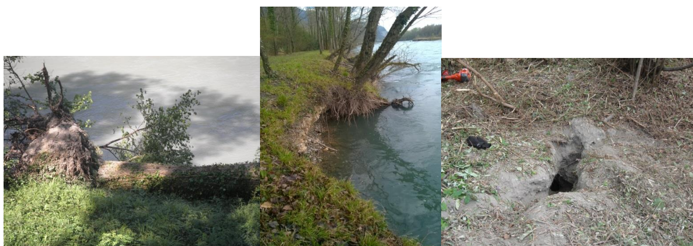
Figure 2 : Exemples de dommages sur digues, dus à la nature (chute d'arbre avec racine, anses d'érosion, terriers de blaireaux)
