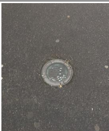
Éclairage par le sol
