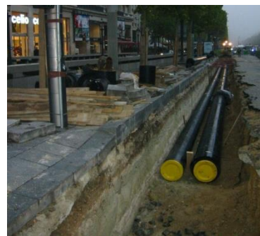
Réseau en pleine terre
