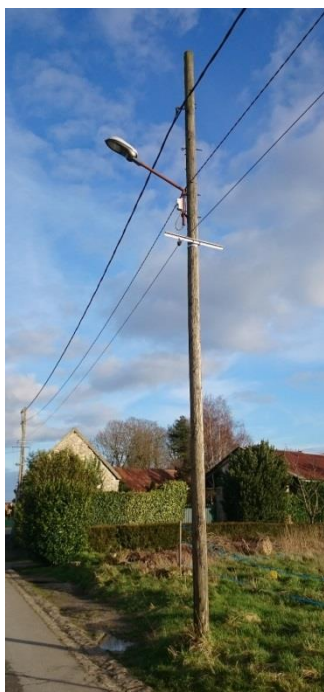
Éclairage public sur support bois commun
