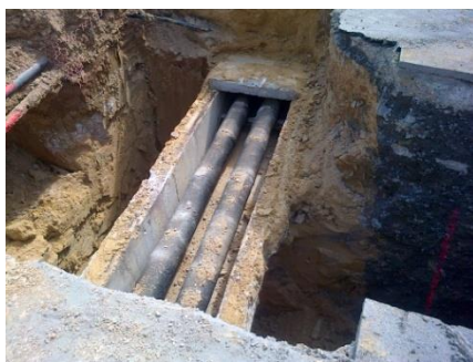
Réseau en caniveau
