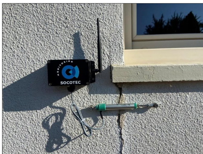
Figure 8 : Capteur de suivi n° 0A002821 sur fissure n° 1.
