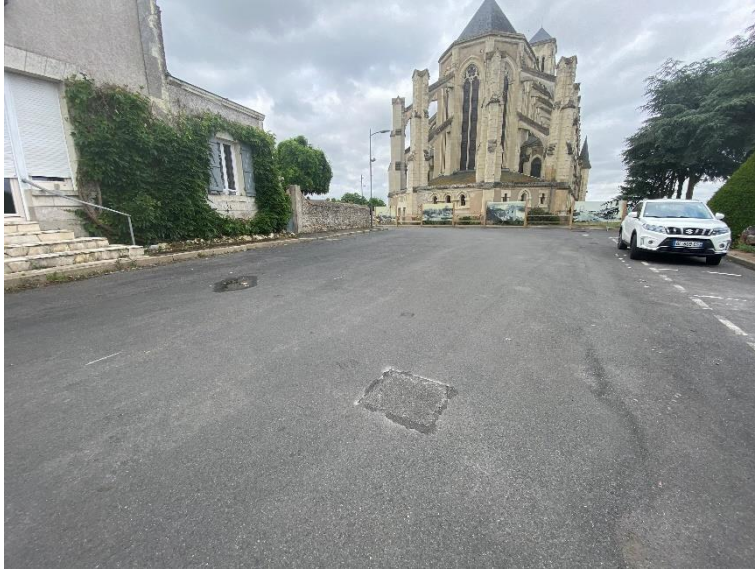
Figure 5 : Montjean-sur-Loire, vue du désordre après travaux.
