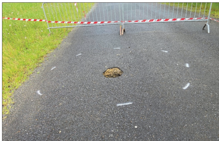
Figure 6 : Vue du désordre sur la chaussée.
