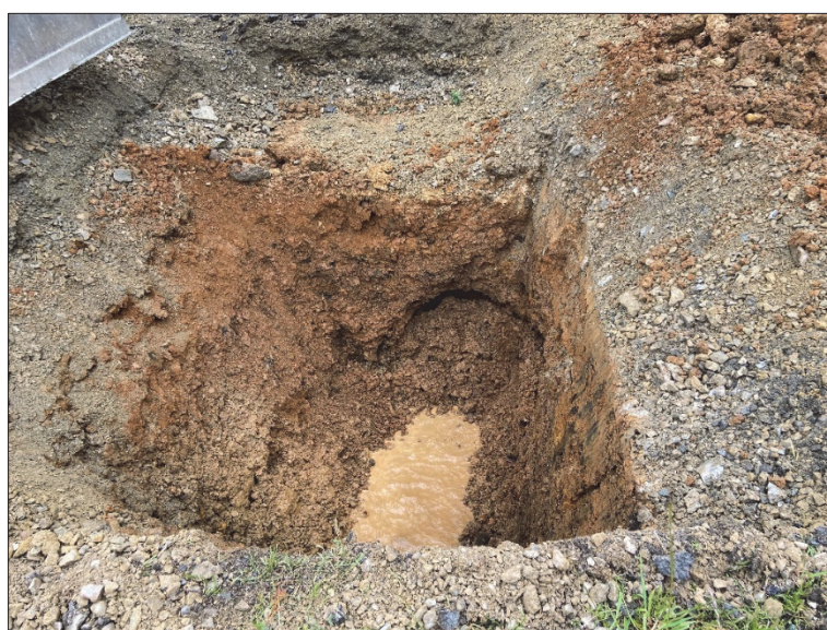
Figure 7 : Ouverture du désordre. Vide en partie comblé sous la chaussée.
