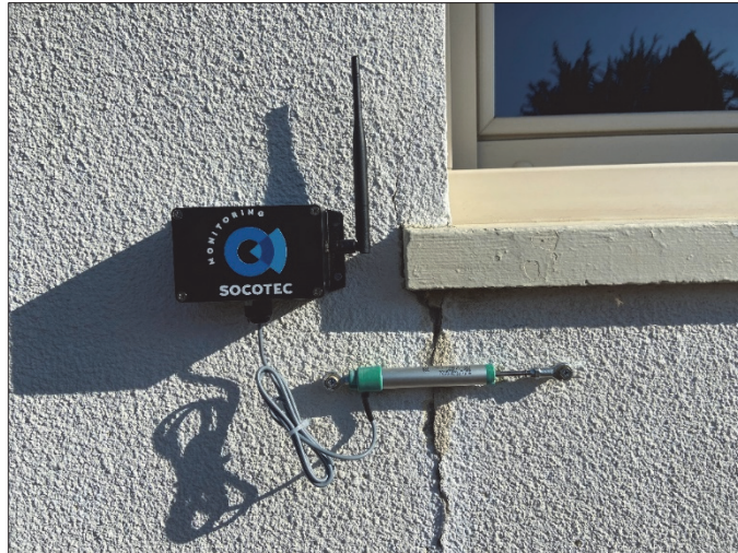
Figure 12 : Capteur de suivi n° 0A002821 sur fissure n° 1.
