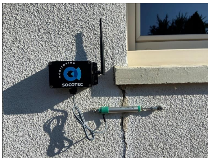
Figure 13 : Capteur de suivi n° 0A002821 sur fissure n° 1.
