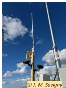
Antenne omni-directionnelle (présence-absence)
