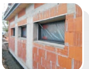
Pont thermique de plancher intermédiaire non traité sur toute la périphérie
