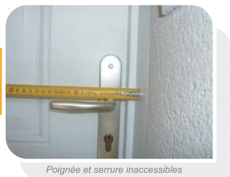
Poignée et serrure inaccessibles
