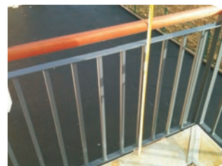
Garde-corps d'une hauteur < 1,00 m
