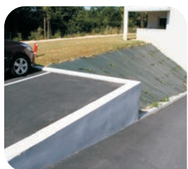
absence de dispositif de protection - risque de chute
