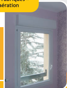
Absence d'entrée d'air dans la chambre
