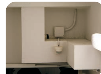
défaut d'isolation entre parc et SAS
