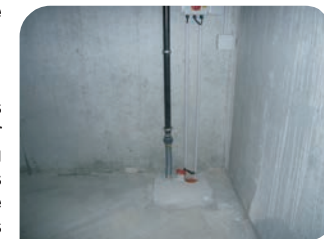
absence de protection de conduits
