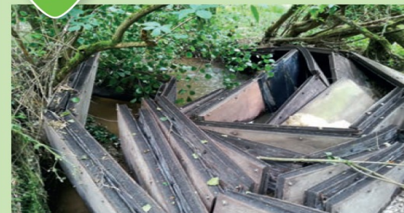
⑪ Exemple d'un dispositif flottant expérimental installé dans une buse de 85 m emporté par le courant, suite à la rupture de l'ancrage sur la tête de buse. Source : Cerema.
