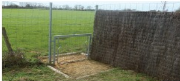
❸ Échappatoire, réseau Vinci Autoroutes. Source : Cerema.
