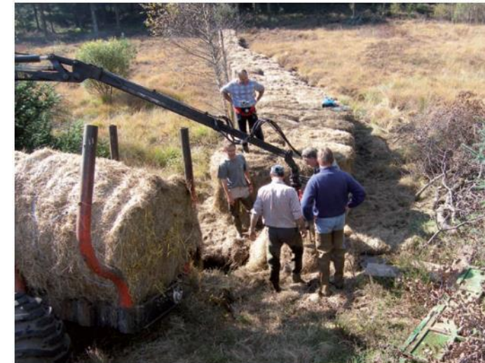
POSE D'UN BARRAGE EN BOTTES DE FOIN À L'AVAL D'UN ETANG POUR LIMITER LES DÉPARTS DE SÉDIMENTS LORS D'UNE VIDANGE
