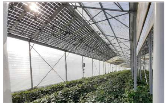
Serre photovoltaïque de Grisolles (82). Passage de lumière versant Sud 17%. Utilisation : maraîchage diversifié en agriculture biologique
