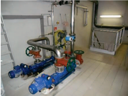
Photographie 18. Pompes d'extraction des boues
