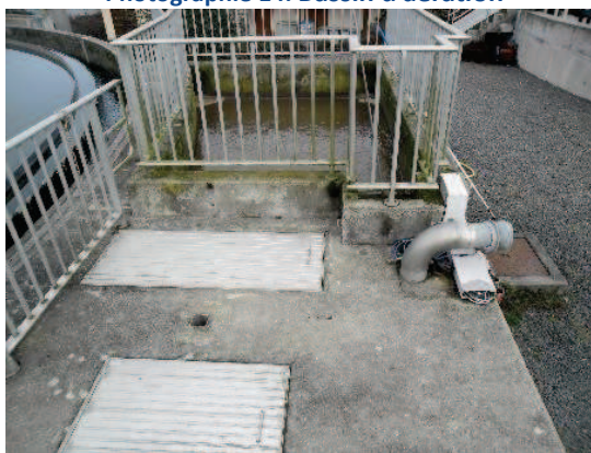
Photographie 16. Dégazeur – Bâche à flottants – Puits à boues
