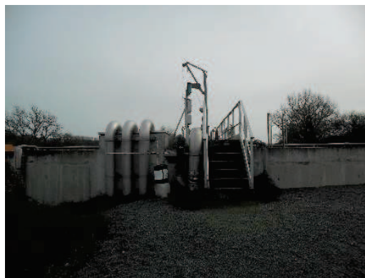
Photographie 14. Bassin d'aération
