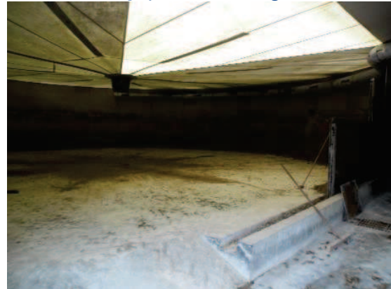
Photographie 21. Silo de stockage des boues
