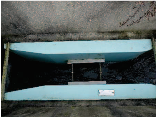
Photographie 20. Canal de comptage en sortie
