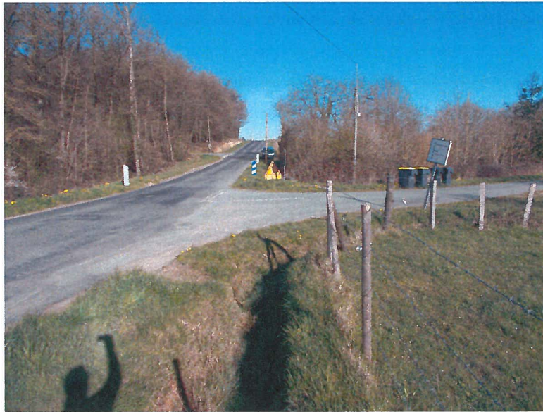
Photo 16 : Busage (DN 2000) du ruisseau de Bonamy traversant la RD249
