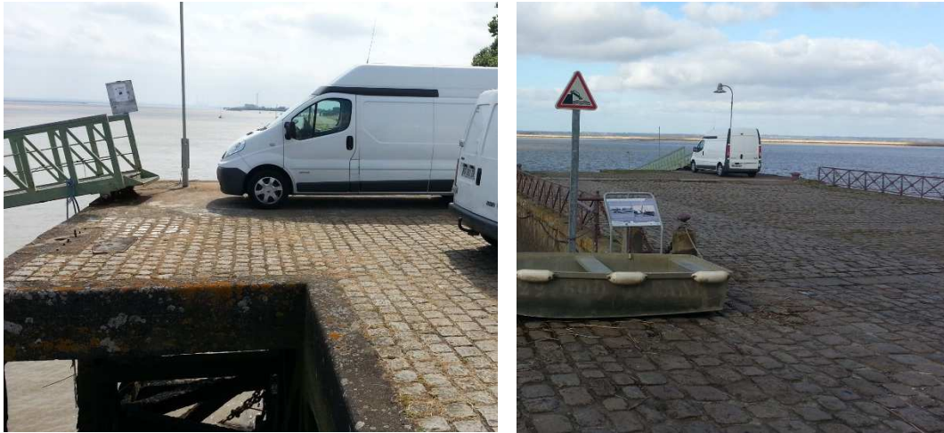
Véhicule stationné sur l'estacade en béton armé au droit du futur accès vers le ponton
