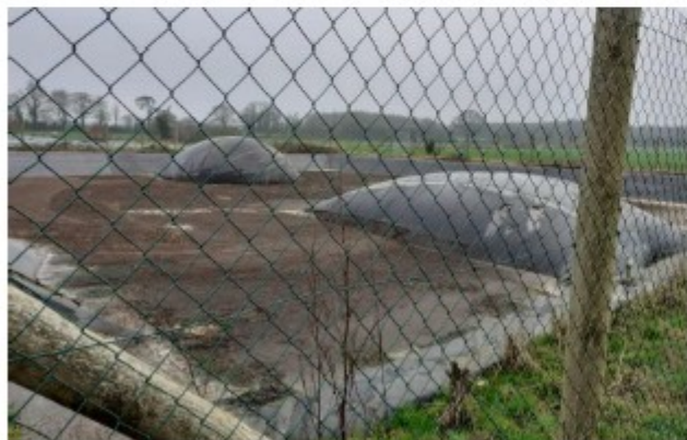
Une fosse dont la géomembrane est percée (nord du département)
