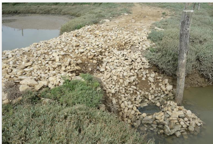
Ouvrage de franchissement défectueux sur le marais Benest – Source : Brice Livoir / Hardy-Environnement
