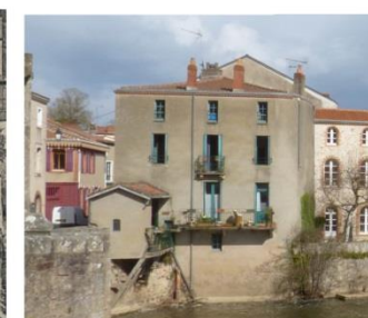
perte des encadrements de baies
