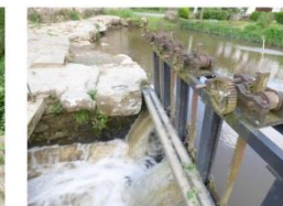
Vanne d'alimentation du coursier de fuite
