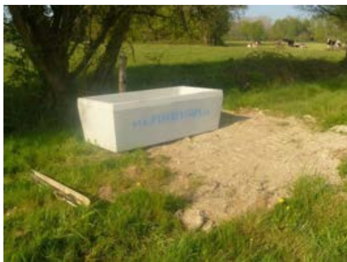
Abreuvoir nouvellement installé
