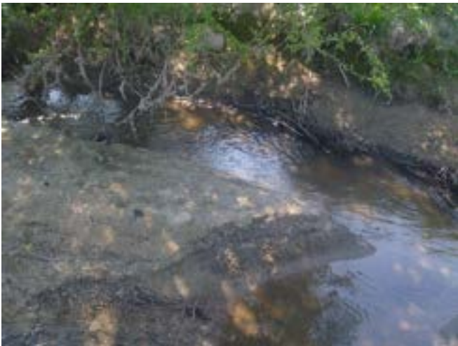
Erosion légère en bas de berge
