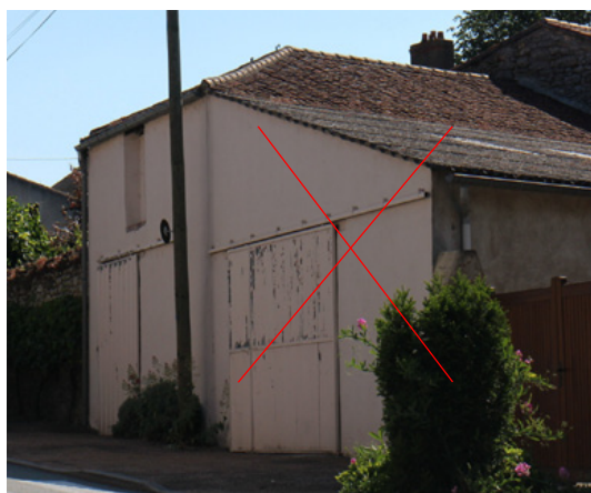
Teinte inadaptée de la fermeture.
