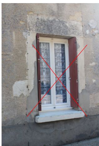
Le blanc immaculé de la menuiserie ne s'intègre pas à la teinte de la façade
