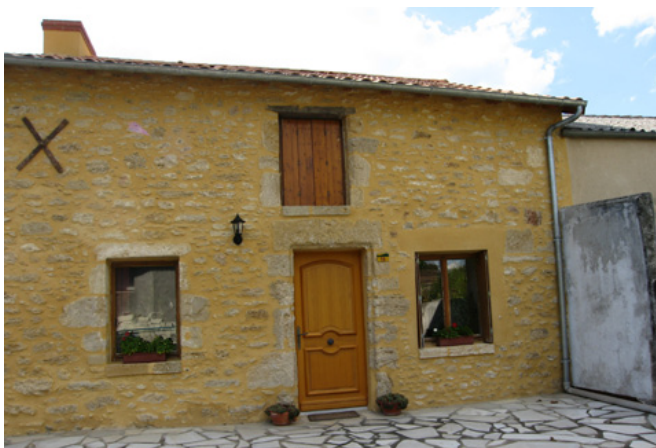
Teinte d'enduit inusuelle sur la commune, jouant un contraste trop fort entre l'enduit et la pierre
