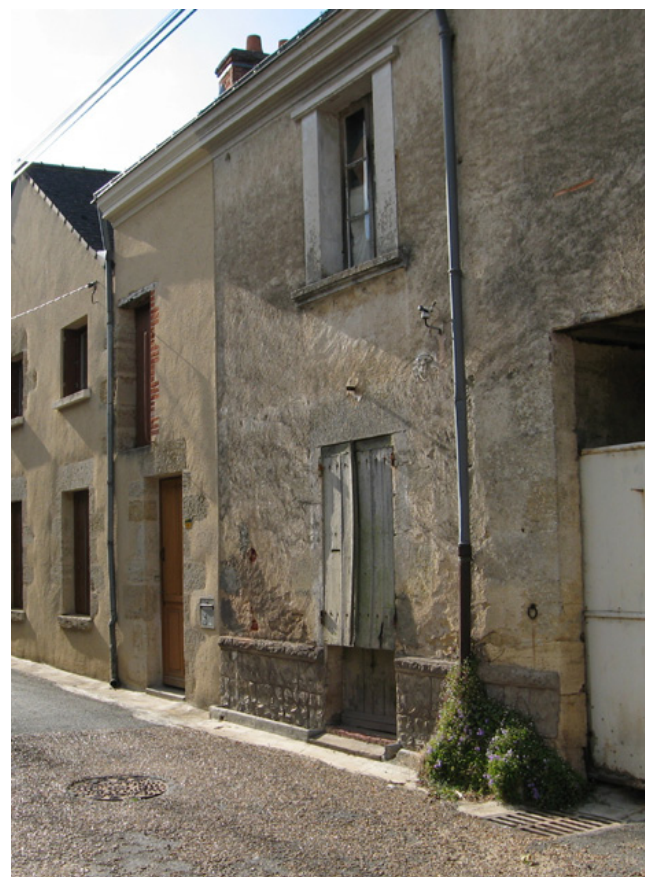
Maçonnerie enduite avec un enduit ciment faisant disparaître complètement les détails d'appareillage de la pierre. Au-delà de l'aspect esthétique, le mur est menacé dans sa pérennité : l'humidité piégée derrière l'enduit rendra friable la pierre.
