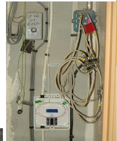
Dans la colonne montante
