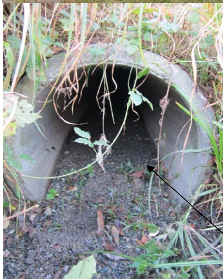
Cananlistion d'entrée DN500
