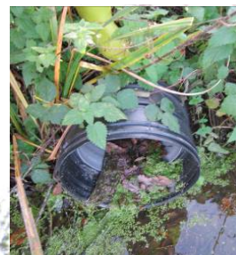
Canalisation de sortie DN350
