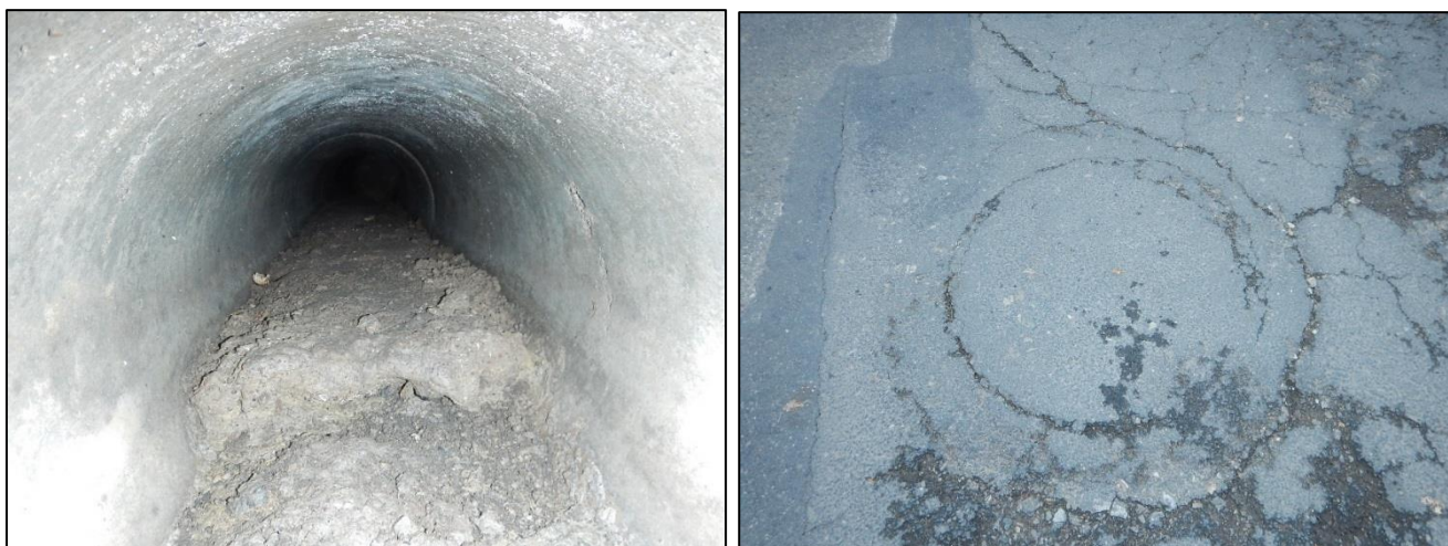
Exemples de constatations terrain – Réseau encombré et tampon non accessible
