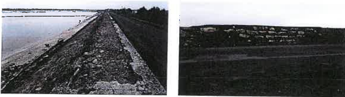
Figure 7 : Désordres du couronnement côté route
