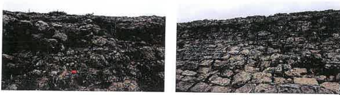
Figure 6 : Désordres du couronnement côté mer
