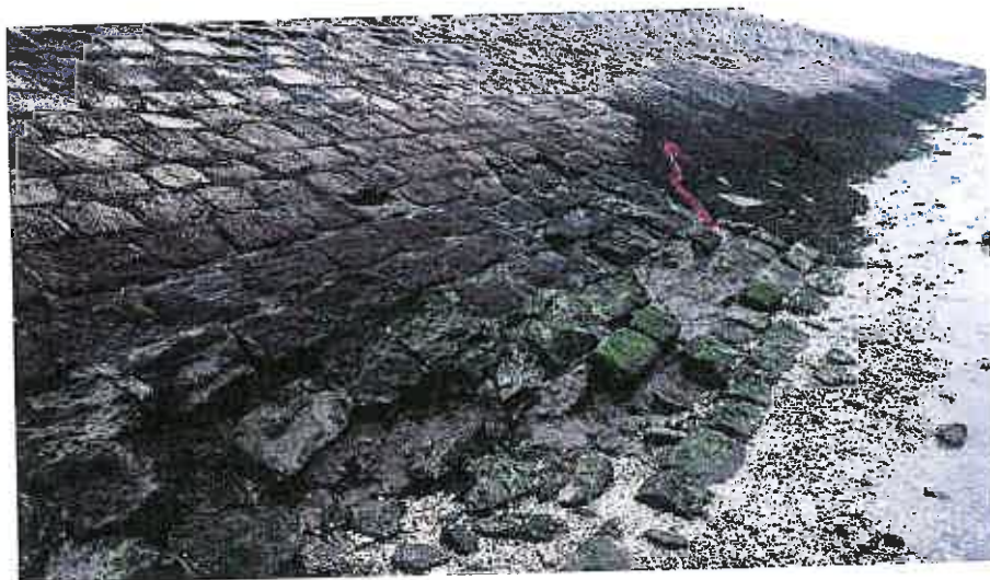
Figure 3 : Désordres en pied d'ouvrage (secteur 1)
