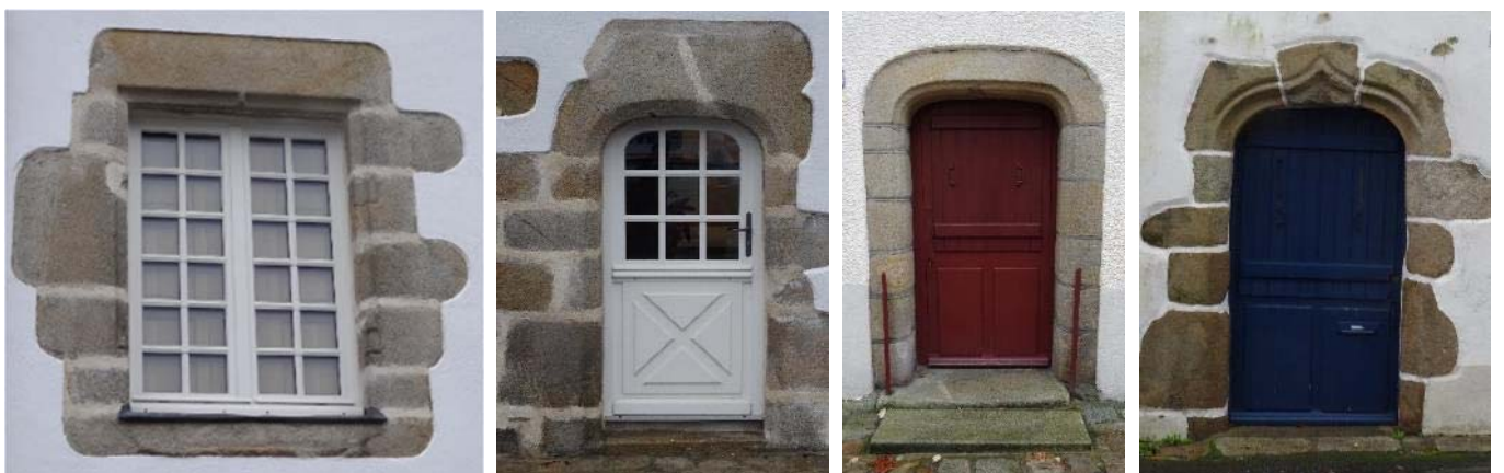
Baie moulurée avec traces de meneau et traverse et bases polygonales ; portes en anse de panier chanfreinée, moulurée et en accolade
